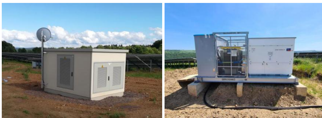
Abb. 1 Beispielhafte Trafostation als Kompaktstation auf einer Freiflächenanlage (links) und Kombistation mit Trafo, Wechselrichter und Schaltanlage auf einem Streifenfundament (rechts)
